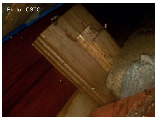
Fig. 12 L'endoscopie permet de détecter des obstacles tels que déchets et balèbres de mortier tapissant la coulisse.
