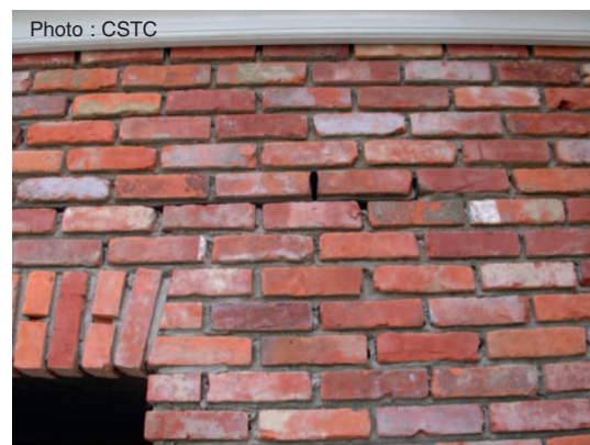
Fig. 13 Drainage de la coulisse et joints verticaux ouverts au droit d'une baie de fenêtre.
