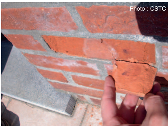
Fig. 6 Briques détériorées par le gel.
