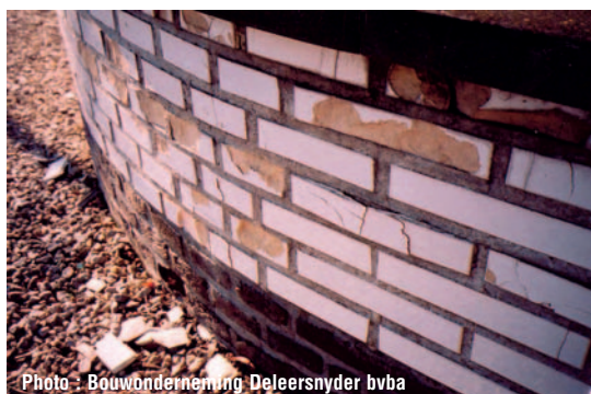
Fig. 9 Maçonnerie en briques émaillées dégradées par le gel.
