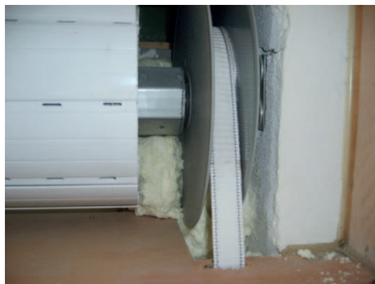
Fig. 20 Pénétration d'isolant dans un caisson à volet : à éviter.
