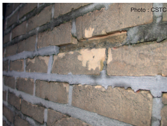
Fig. 8 Mortier de pose dégradé par le gel (zones de teinte claire) et descellement des joints.
